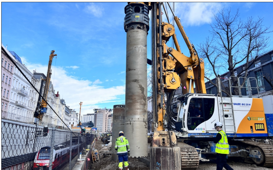
Herstellung Bohrpfähle zwischen Hst. Rennweg und Bf. Wien Mitte (zeitgleich vier Bohrgeräte)
